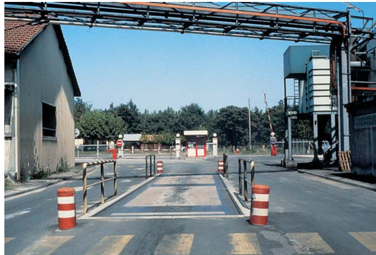
Figure 16. Implantation d'un pont bascule sur le parcours des camions.
