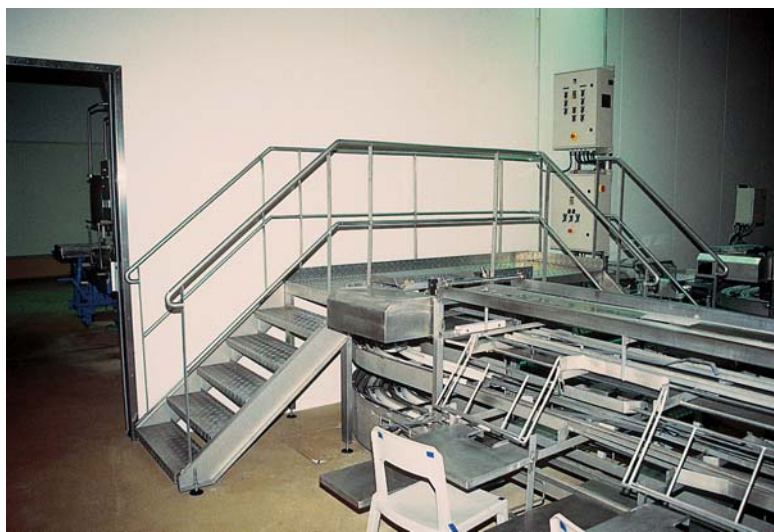
Figure 38. Passage protégé au-dessus de convoyeurs.
